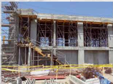
Presas y Depuradoras PTAR La Chira. Lima
