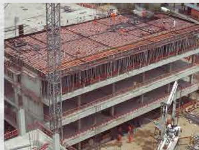
Hospitales y Malls Hospital Lima Este - ATE, Lima
