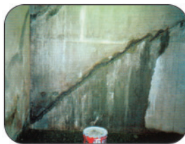
Etap 1 Filtración de Agua
