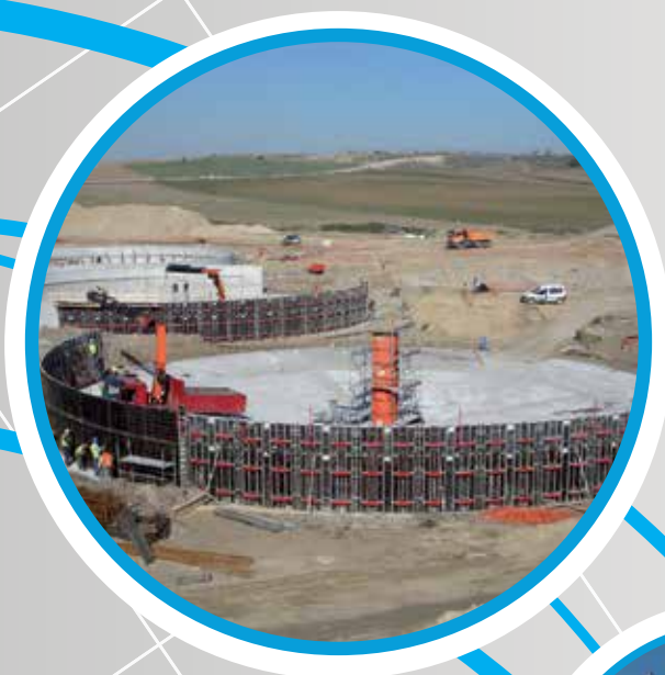
Plantas de Tratamiento de Aguas
