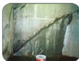
Etapa 1 Filtración de Agua
