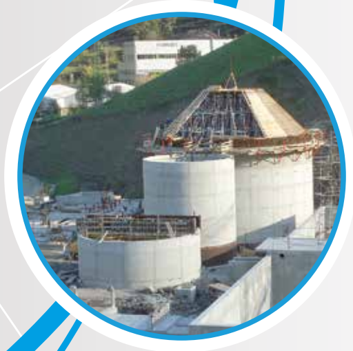
Reservorios, canalizaciones y depósitos
