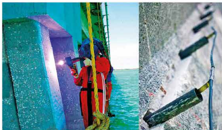
Control de Corrosión
