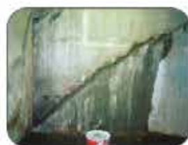
Etap 1 Filtración de Agua
