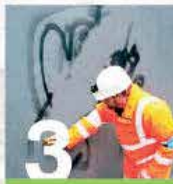
El graffiti se elimina lavando la superficie con agua
