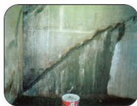
Etap 1 Filtración de Agua
