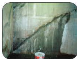
Etap 1 Filtración de Agua
