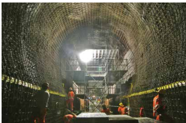
La trampa de rocas tiene una longitud de 59.05 m. La sección es de tipo herradura y tiene un diámetro de 6.50 m. La pared está revestida por concreto lanzado sobre una malla de acero de 300 mm de espesor.
