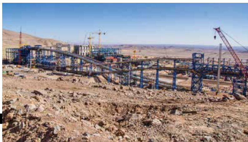
La correa transportadora (CV-110) tiene una capacidad de 13,200 Tn por hora, un largo de 770 m y ancho de 84pulg.
