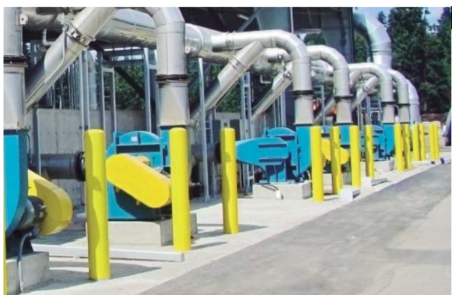
En líneas generales los ventiladores axiales son aptos para mover grandes caudales a bajas presiones.
